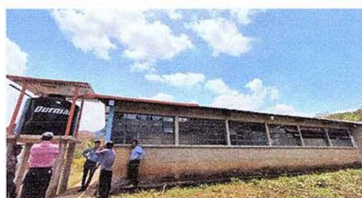
Foto 16: se necesita pintura exterior
