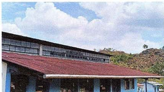
Foto 1: láminas deterioradas parte de enfrente. Aula 1
