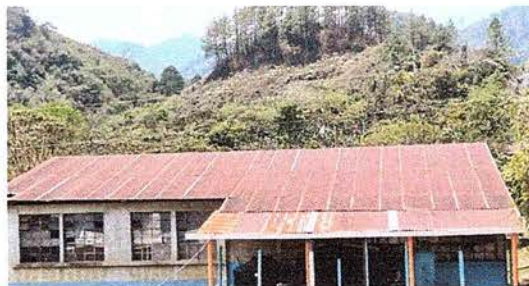
Foto 2: láminas deterioradas parte de atrás. Aula 1
