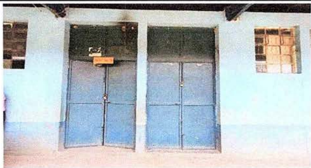
Foto 7: puertas de salon 1 necesita mantenimiento
