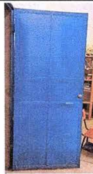
Foto 10: puerta 4, necesita, mantenimiento
