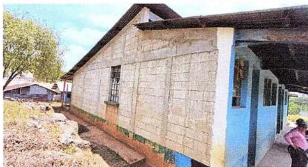
Foto 15: se necesita pintura exterior
