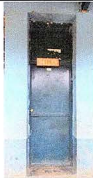
Foto 8: puerta 2 necesita mantenimiento
