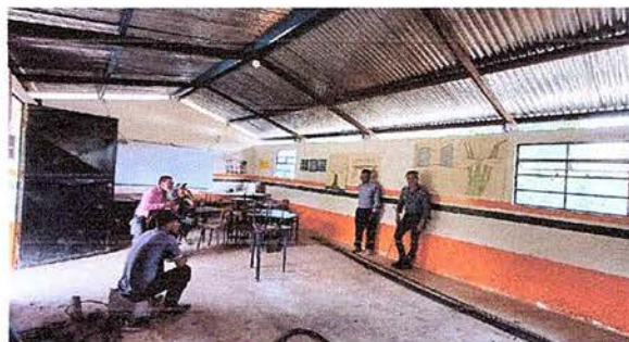
Foto 22: se necesita pintura interior, ambiente 4
