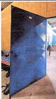
Foto 9: puerta 3, necesita mantenimiento
