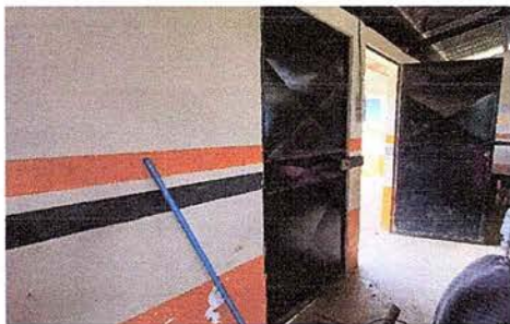
Foto 11: puerta 5 y 6 necesita mantenimiento
