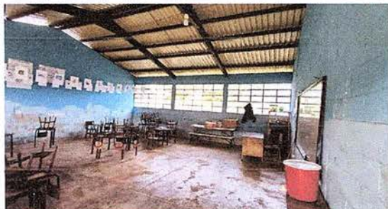
Foto 19: se necesita pintura interior, ambiente 1
