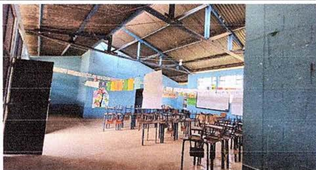
Foto 21: se necesita pintura interior, ambiente 3
