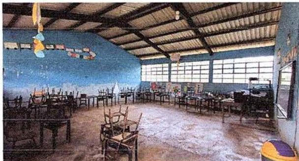
Foto 20: se necesita pintura interior, ambiente 2
